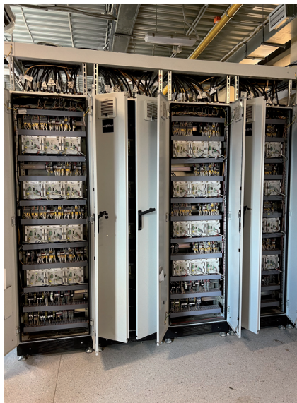
Устройства МПЦ-ЭЛ в электродепо Аминьевское
