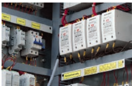
Рис. 5. Шкаф управления трамвайной автоматикой
