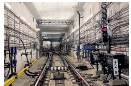
Напольное оборудование цифровых систем автоматики в тоннеле Московского метро
