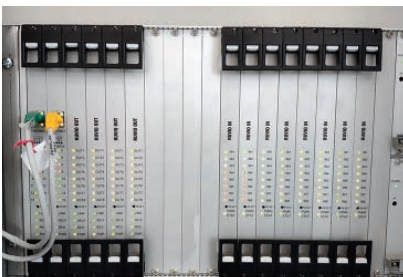
Релейные контроллеры RUVIO системы РПЦ-ЭЛ в электродепо «Солнцево»
