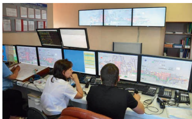
АРМ ДСП в гибридной централизации РПЦ-Е
